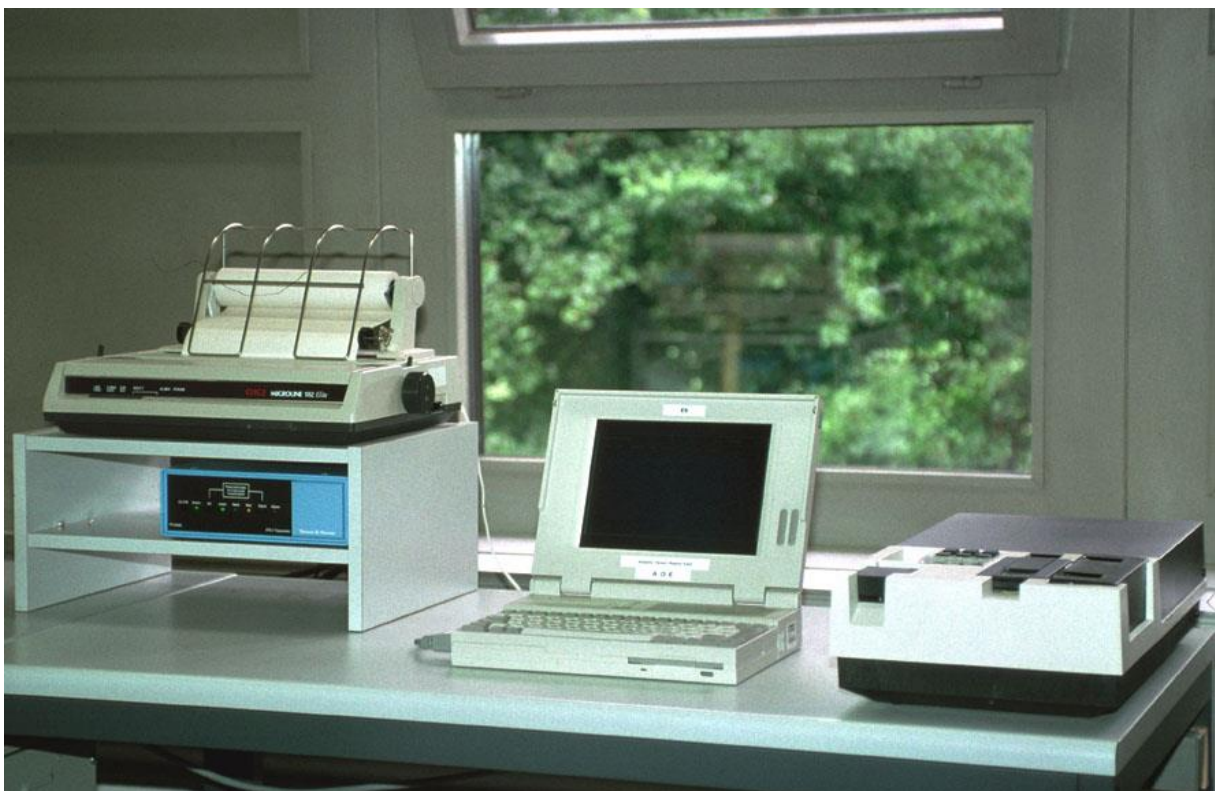
Die EDA Inmarsat C , (TT) „ Capsat “ Satellitenfunkanlage in der Mittellandzentrale Murain .
